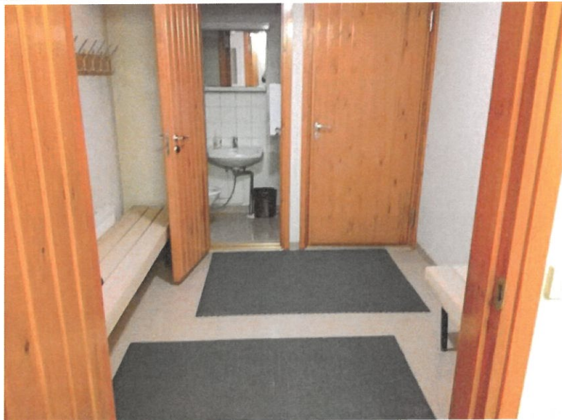
Poikien pukuhuone ja wc. Lattiat Gann 78-95=kosteita
