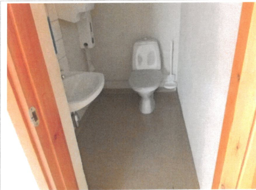
Tyttöjen wc lattia on kostea. Gann 96
