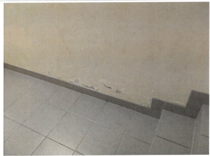
Käytävän seinän maali on lohjennut. Gann 90-127 eli kostea
