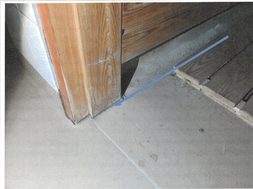
Saunan ovenkarmin kohdalla on maton tiivistykset halki
